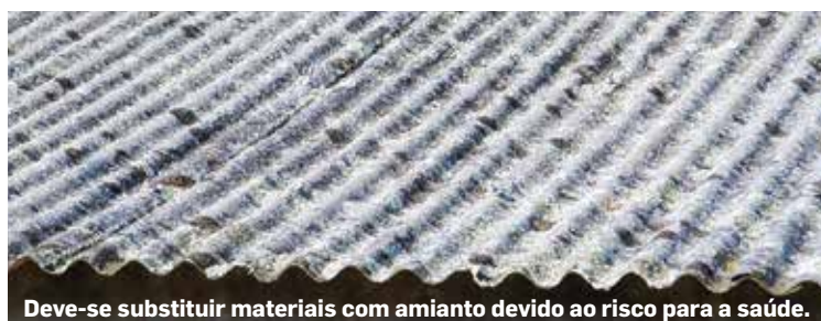
Deve-se substituir materiais com amianto devido ao risco para a saúde.
